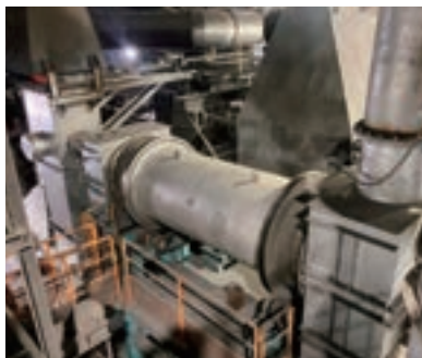
材料予熱設備
